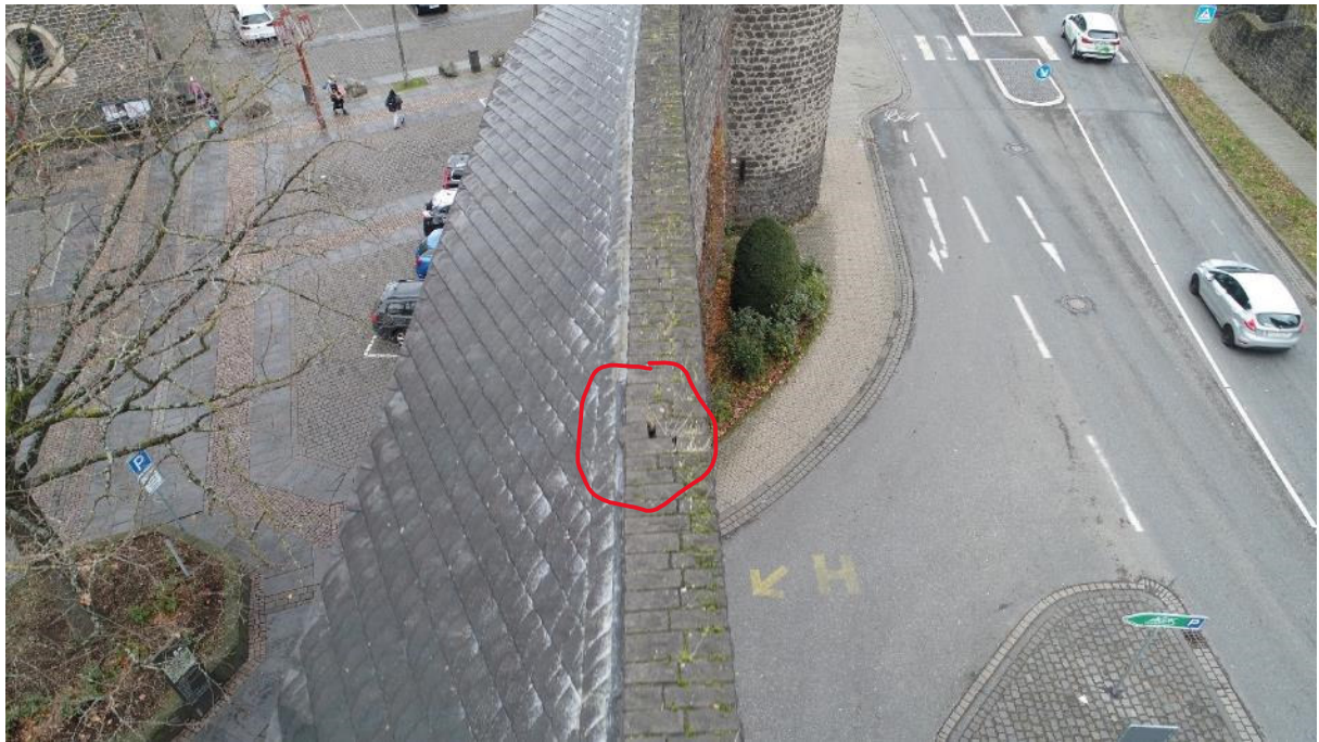
04. Foto vom 28.11.2023 oberer-Burgfrieden / loser Stein (Schaden 2024 behoben)
