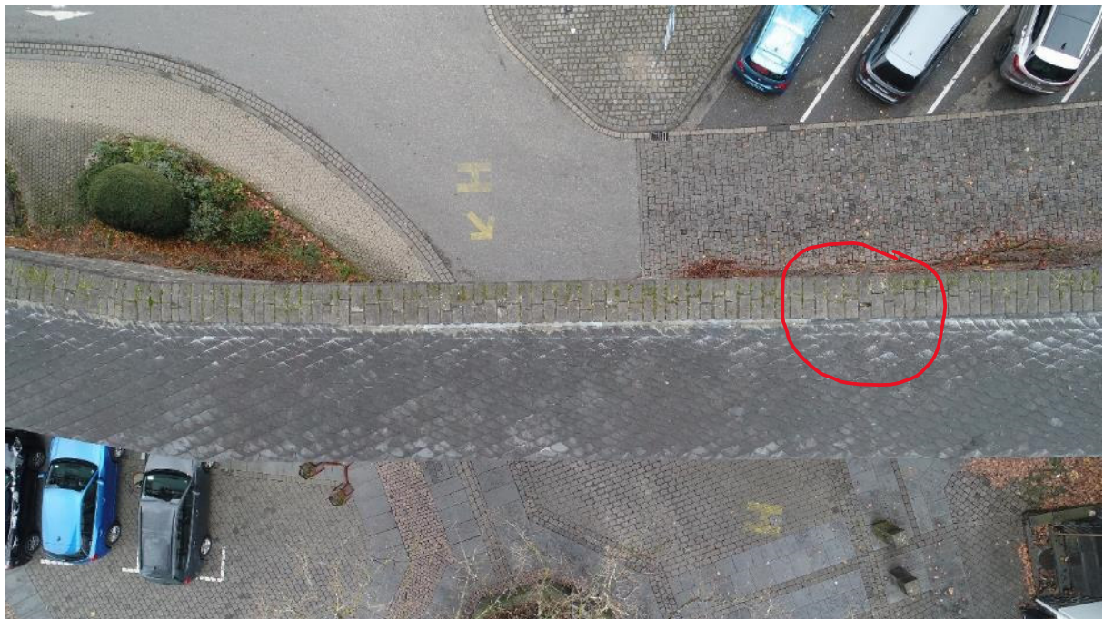
05. Foto vom 28.11.2023 oberer-Burgfrieden / loser Stein (Schaden 2024 behoben)
