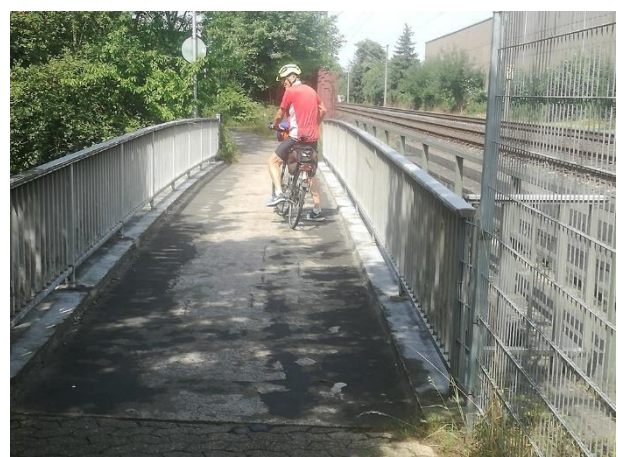
Foto 20: Die sanierungsbedürftige Brücke über die Hauptstraße ist zu schmal und ihr Gelände zu niedrig. Um einen Ersatzbau zu vermeiden, sollte ein höheres Gelände an den Seiten der Brücke befestigt werden. Zwischen den Geländern entsteht damit eine Breite von knapp 2,5 m.
