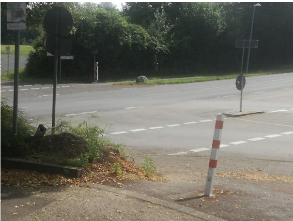
Foto 03: Kreuzungsbereich zur L125 von der Kurhausstr. gesehen. Auch der Einmündungsbereich der Kurhausstr. ist umzugestalten.
