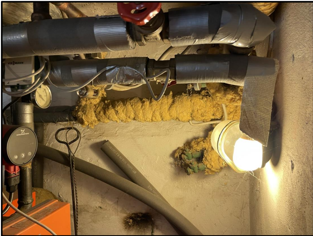
Abb. 5: KMF und Kunststoffdämmung Heizungsrohre
