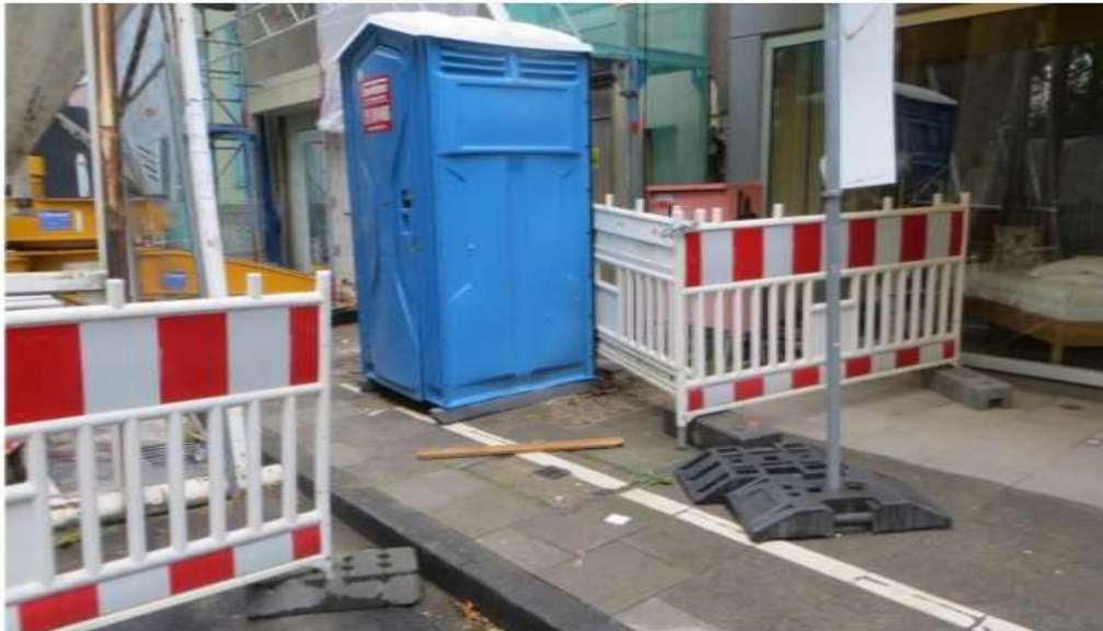
Abbildung 9: Offene, gefahrenträchtige Baustelle in der Bahnhofstraße (Quelle: Planersocietät)
