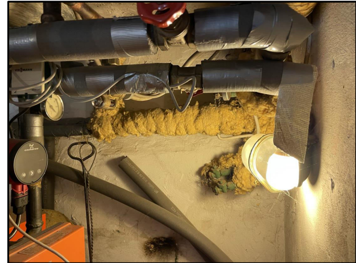
Abb. 5: KMF und Kunststoffdämmung Heizungsrohre
