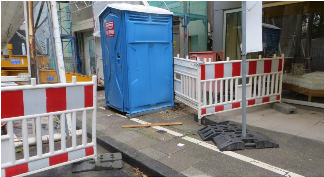
Abbildung 33: Offene, gefahrenträchtige Baustelle in der Bahnhofstraße
