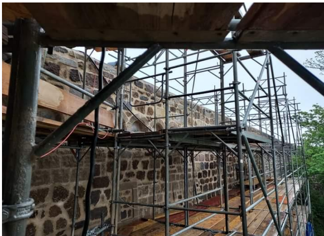
Abbildung 17: Mauersanierung Quelle: Stadt Siegburg
