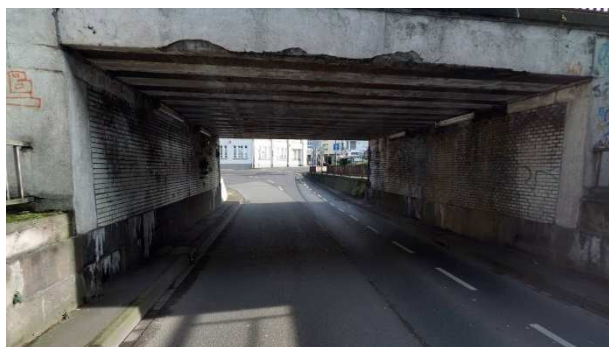
Bild 74: Bahnunterführung – Fahrbahn Fahrtrichtung West nach Ost (in Richtung Mahrstraße) [Bildquelle: Street Smart]
