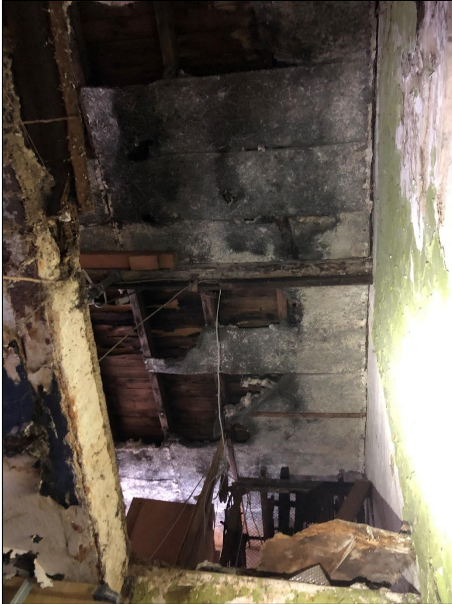
Abbildung 18: Marode Dachkonstruktion mit starker Beschädigung durch Feuchtigkeit
