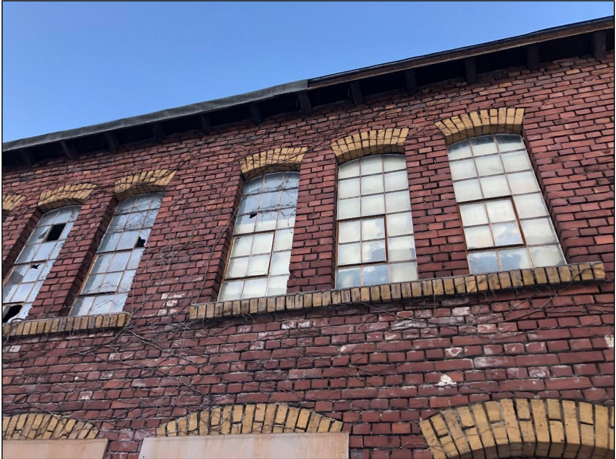
Abbildung 16: Außenfassade des Backsteingebäudes mit fehlendem Fugenmaterial und beschädigten Glasfenstern
