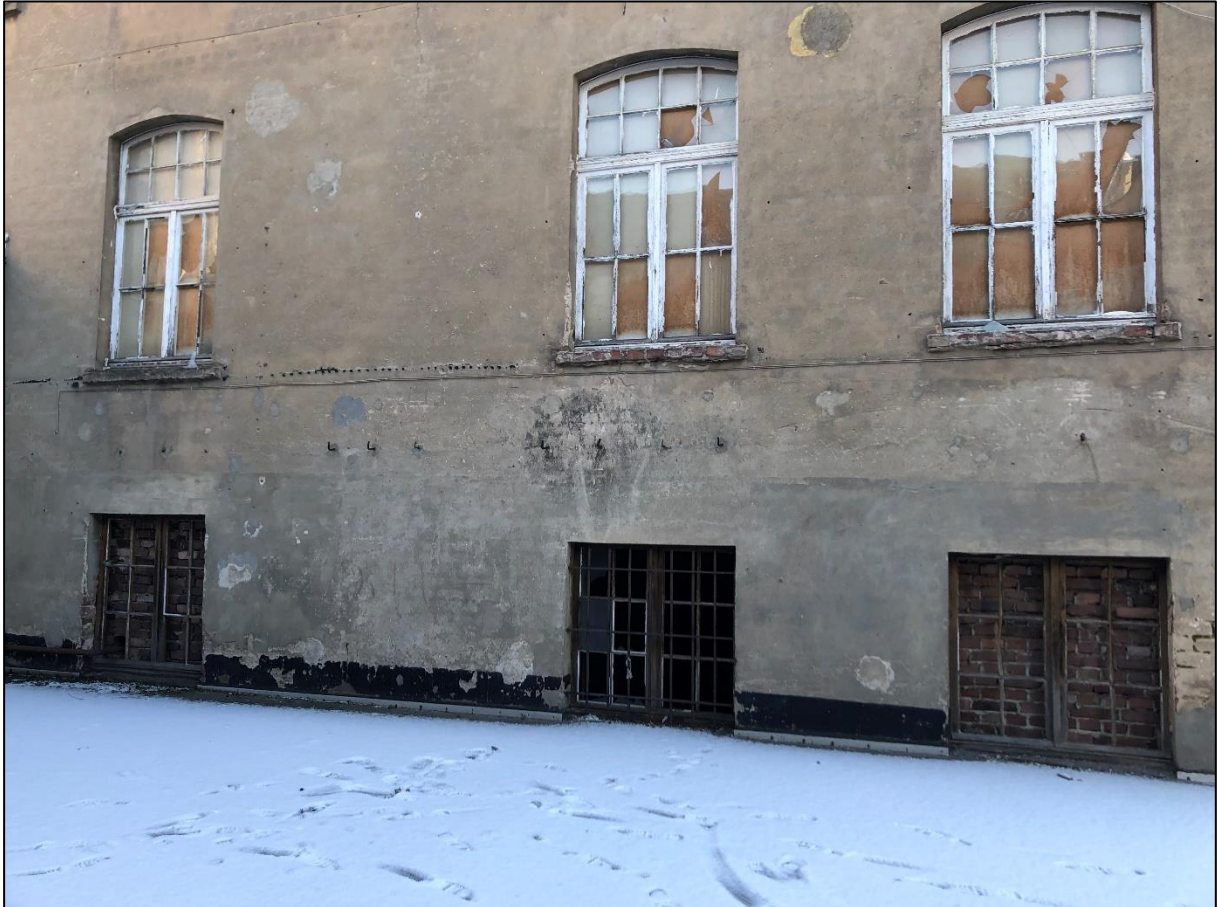
Abbildung 5: Verschlossene Fensterbereiche und fehlende Verdeckung des mittleren Kellerfensters
