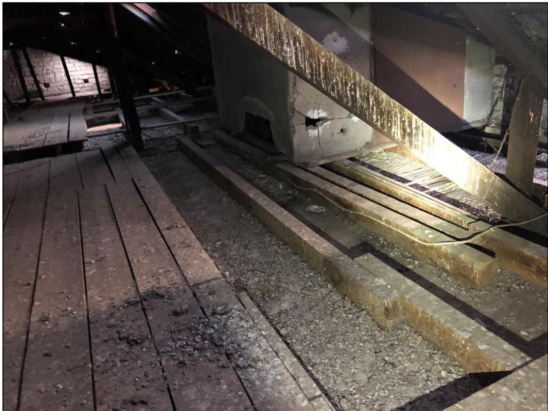
Abbildung 10: Dachboden mit starker Verkotung
