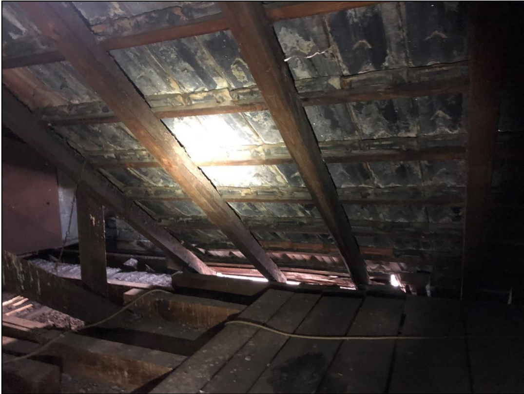
Abbildung 9: Dachkonstruktion ohne Dämmmaterial und Einflugöffnungen im Bodenaußenbereich
