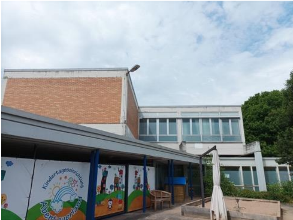
Abbildung 9: Blick vom Innenhof der ehemaligen Schule. Rings um das Gebäude finden Fledermäuse potenzielle Lebensstätten im Bereich der Attika vor.
