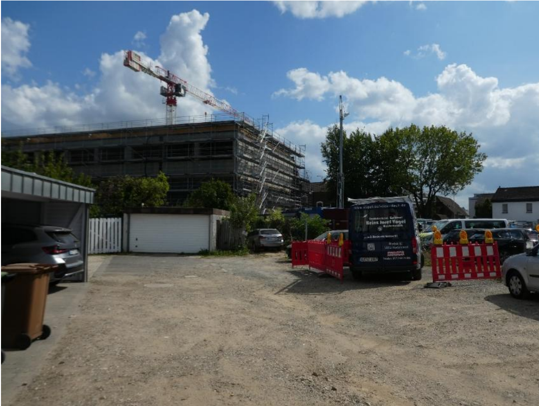
Abbildung 4: Blick auf den Bereich der geplanten Erweiterung des Bebauungsplans 50/8 im Südwesten des Gebiets. Die Fläche wird zurzeit größtenteils als Baueinrichtungsfläche und Parkplatz genutzt (21.08.2025).
