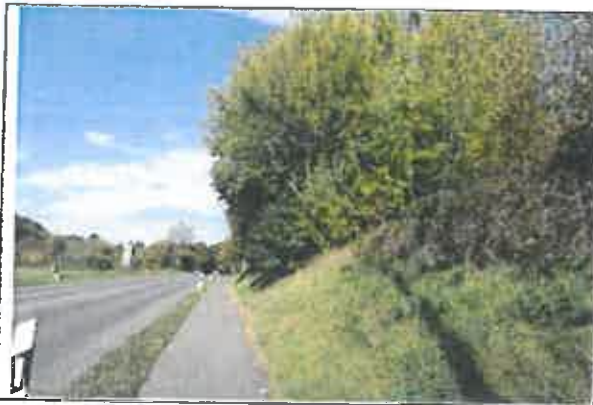
Foto 1: Böschung an der Idsteiner Straße
