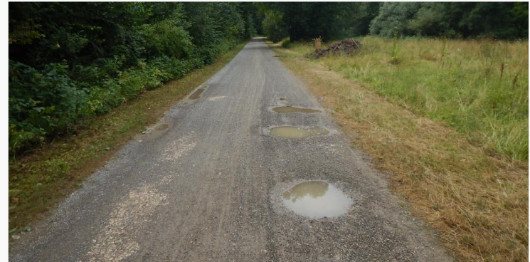
Negativbeispiel: verdichtete wassergebundene Decke mit Pfützenbildung und schlechter Wasserdurchlässigkeit
