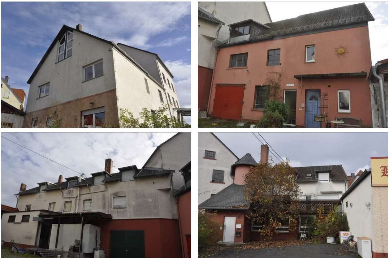
Abbildung 3: Wohnhaus und weitere Anbauten um das ehem. Mühlengebäude herum mit Spalten am Dachüberstand und Hohlräumen in Rollladenkästen
