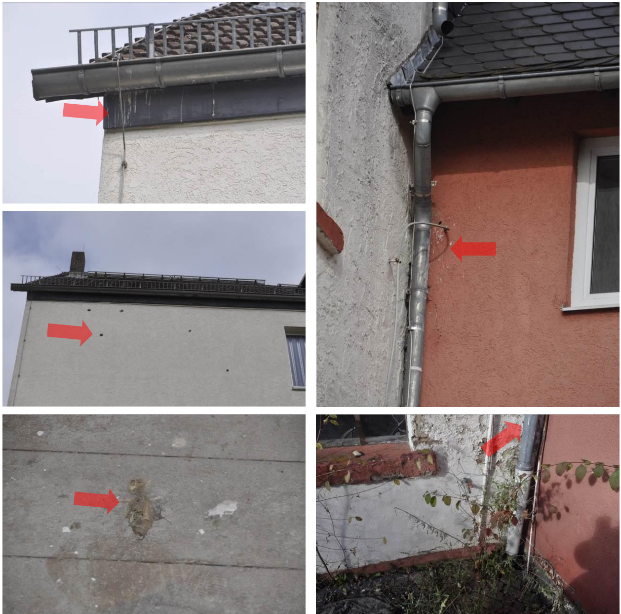
Abbildung 8: Kotspuren unter der Dachtraufe und am Fallrohr einer Dachrinne (oben-links u. rechts), Spechtlöcher in der Fassade des Wohnhauses (Mitte) und totes Taubenküken in der ehem. Mühle (unten)
