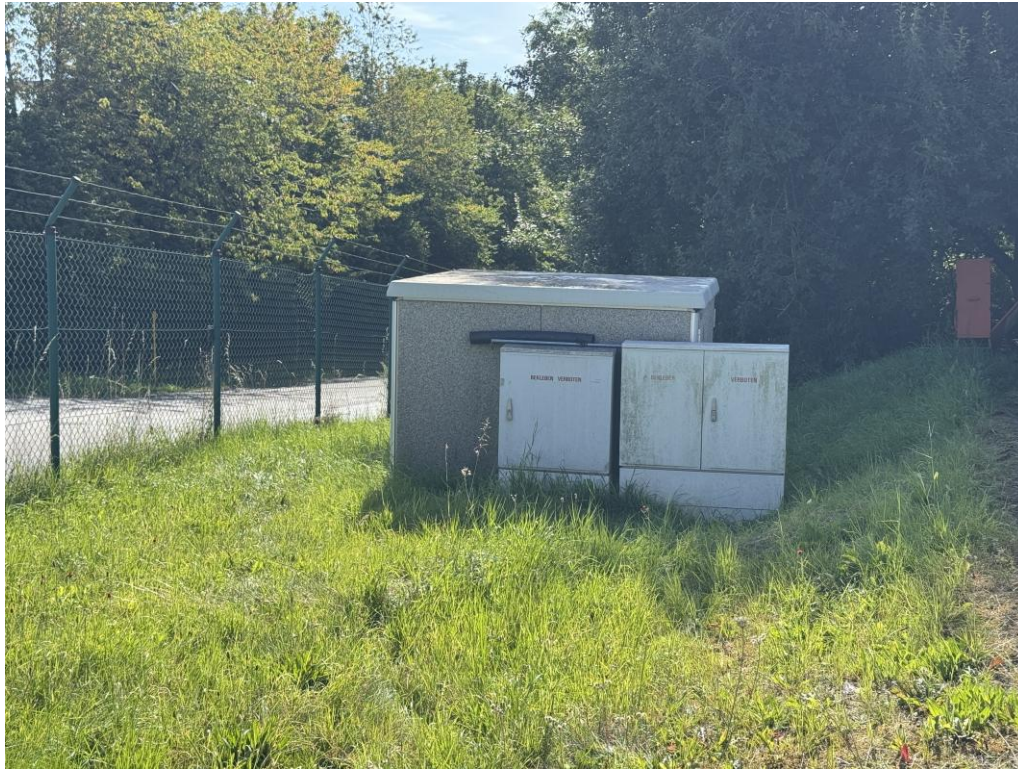
Abb. 6: Übergabestation WAB Rennerod
